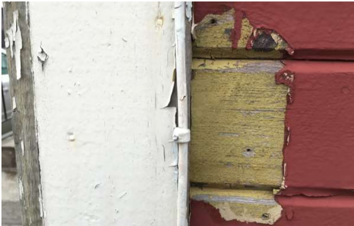
Detaljbild från östra fasaden, september 2016. En gulockra finns under den faluröda akrylatfärgen.
